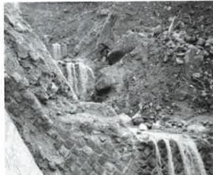
土石流により被災した泥谷砂防えん堤群
