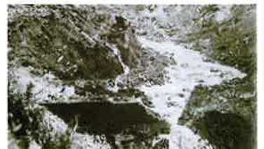
破壊された湯川第1号えん堤
