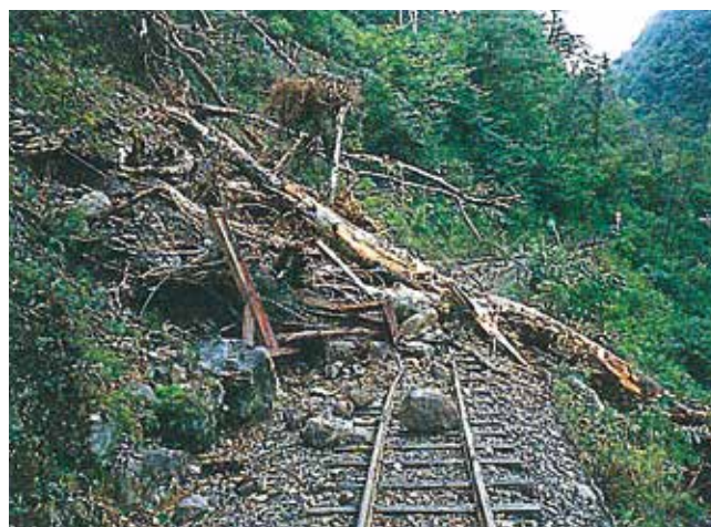
土砂崩れで倒された大木に遮断された工事専用軌道
