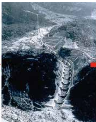
1933 (昭和8) 年 階段式砂防堰堤と山腹工を組み合わせ た砂防工事が行われた
