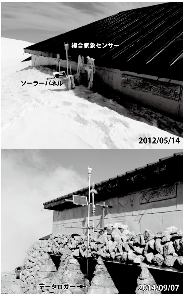
図2 大汝休憩所に設置した無人気象観測装置。 上は積雪期の状況(2012年5月14日)、下は無雪期の状況(2014年9月7日)。
