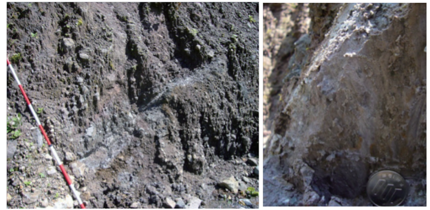
写真11 湯川第13号砂防堰堤左岸道路のり面の断層露頭、熱水変質帯に沿っている。右はせん断面の条線
