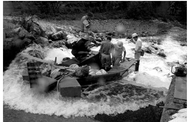
写真15 流砂計測ピット内の砂礫の除去と水中加重計の点検状況（右岸上流より撮影）
